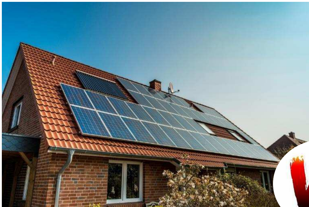
Panneaux solaires Photovoltaïque
